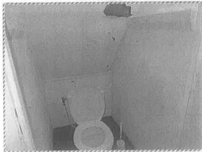
Une partie de la peinture se détache au niveau des murs.
